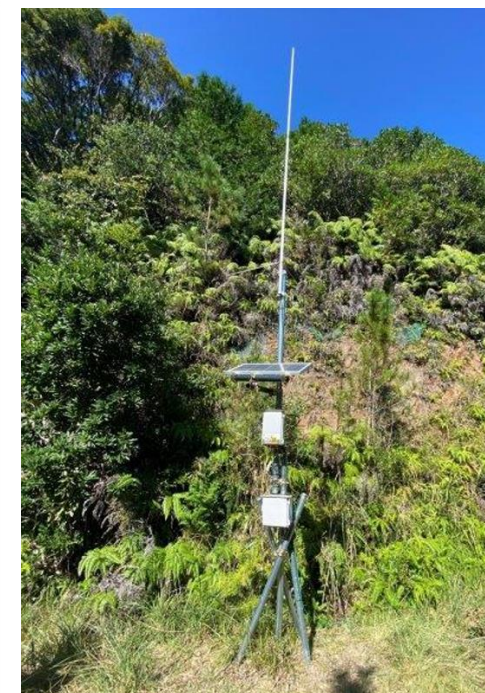
親機の設置状況
