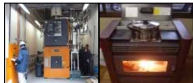
木くず焚きボイラー、ペレットストーブ、石炭混焼 等
