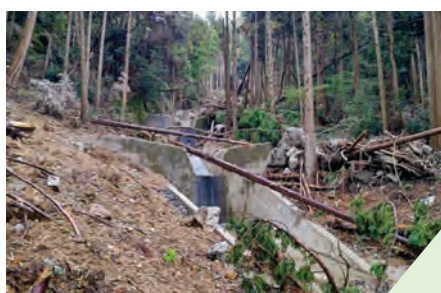
治山施設が溪流の縦方向、横方向の浸食を軽減
