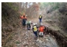
東北森林管理局が林道施設の被害状況・復旧工法の検討について宮城県を支援
