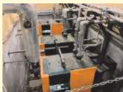
介護施設に導入されたボイラー
