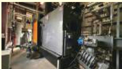
木質チップボイラー設備
