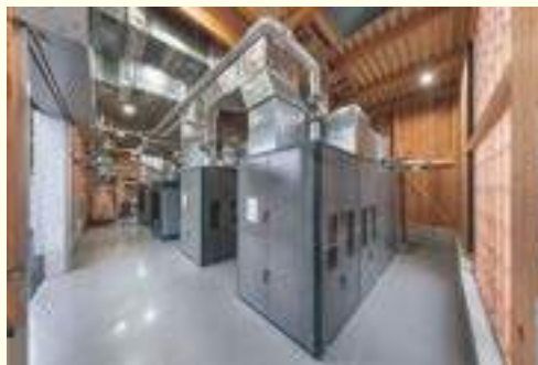
ガス化熱電併給設備
