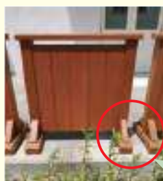
屋外に設置した 木製フェンスの脚部
