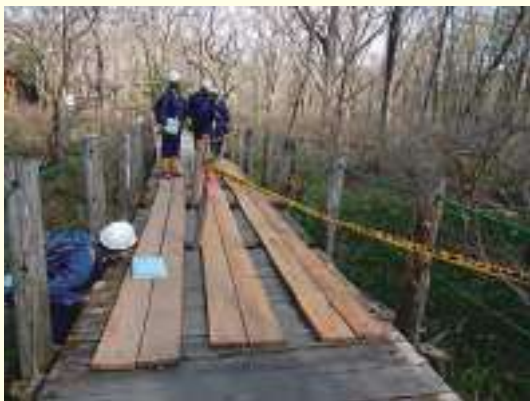
戸隠森林植物園の木道の損傷点検
