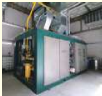
ガス化ユニット
