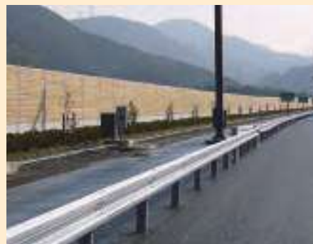
新東名高速道路 木製遮音壁
