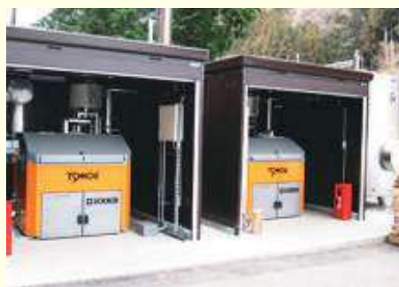
設置された薪ボイラー
