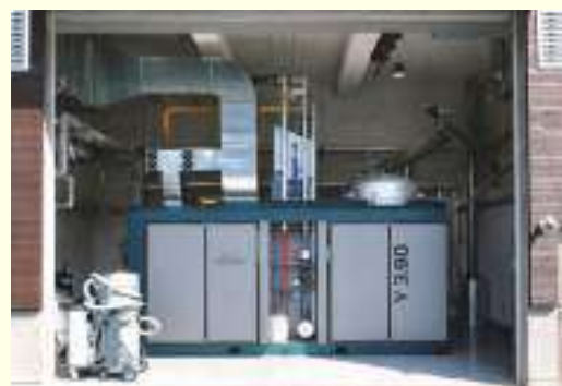
木質バイオマス発電の設備
