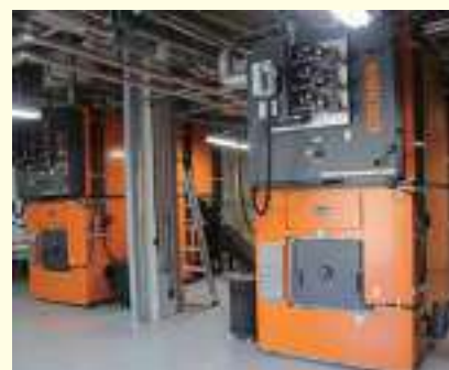
一の橋地区木質バイオマスボイラー
