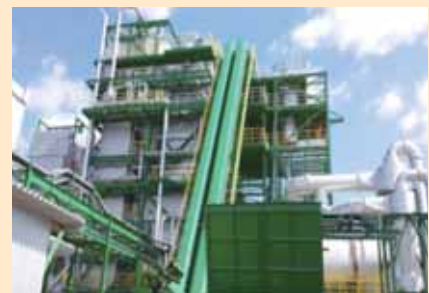
木質バイオマス発電施設の外観(大分県日田市)
