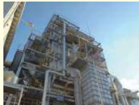
木質系災害廃棄物を発電燃料に活用している バイオマス発電所
