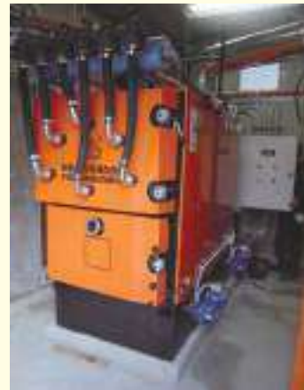
導入された木質チップボイラー
