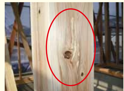
構造材として使用されたあかね材(丸囲い部分が食痕箇所)
