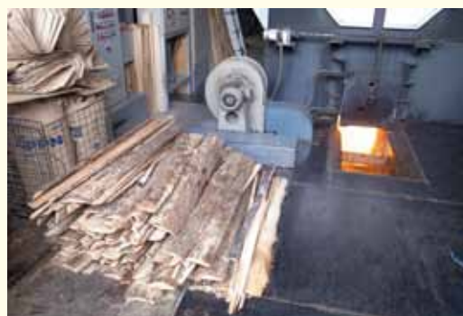
チップボイラー(右奥)と燃料となる工場残材(手前)
