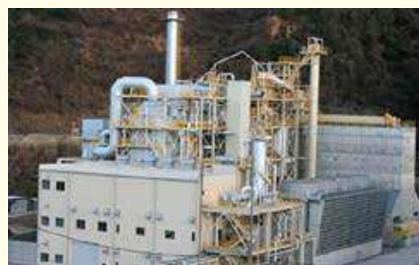
木質バイオマス発電設備
