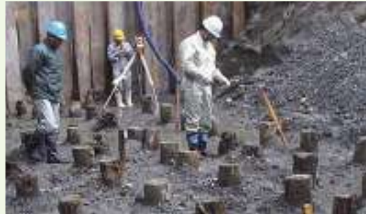
あすわ 足羽川（福井県）の幸橋の基礎として74年間地中にあった木杭（マツ属）の杭頭部分。木杭は極めて健全であることがわかった。
