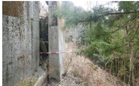
⑤ 林道擁壁の被災状況
