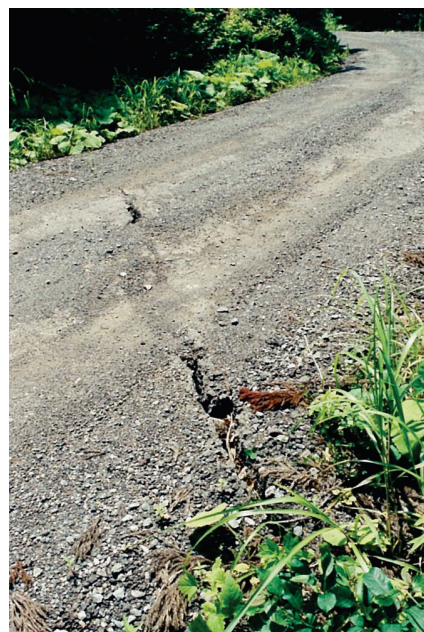
④ 作業道を横断する亀裂
