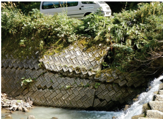
④ 護岸工に生じた変状
