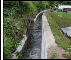
老朽化した用水路の整備・更新
