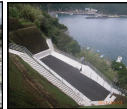
漁村における津波避難対策のための津波避難対策（避難地、避難路の整備）
