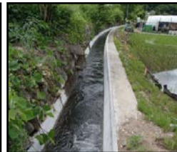
老朽化した用水路の整備・更新
