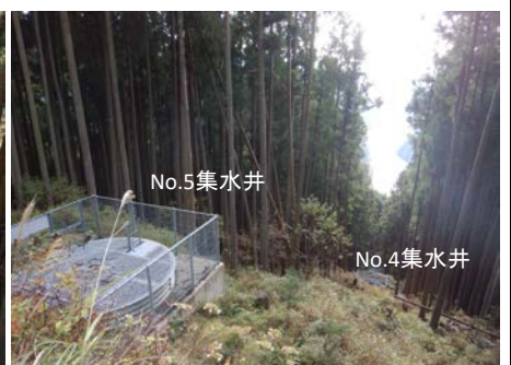
⑥No.5集水井及びNo.4集水井
