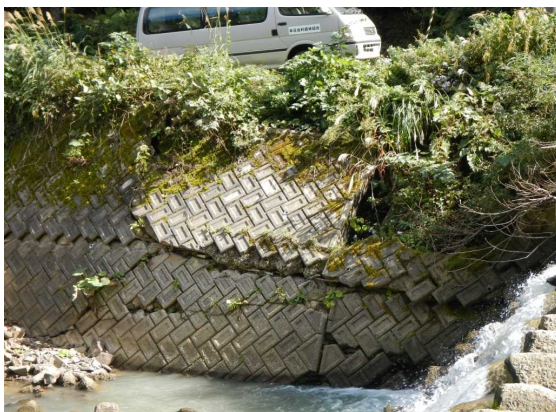
④ 護岸工に生じた変状
