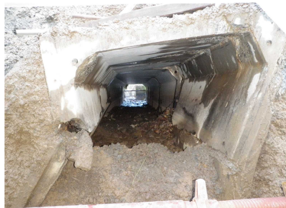
⑤ 町道横断水路工に生じた変状
