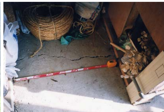
② 被災状況（家屋内に発生したクラック）
