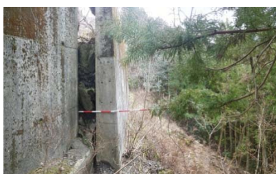
⑥ 林道擁壁の被災状況
