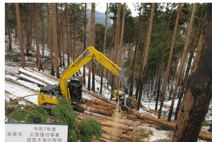
焼損した被災木の伐採（2026年1月）
