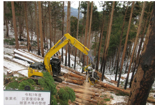
焼損した被災木の伐採 (2026年1月)
