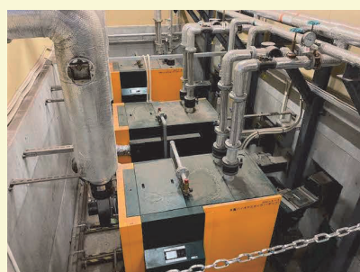
介護施設に導入されたボイラー
