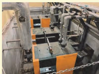
介護施設に導入されたボイラー
