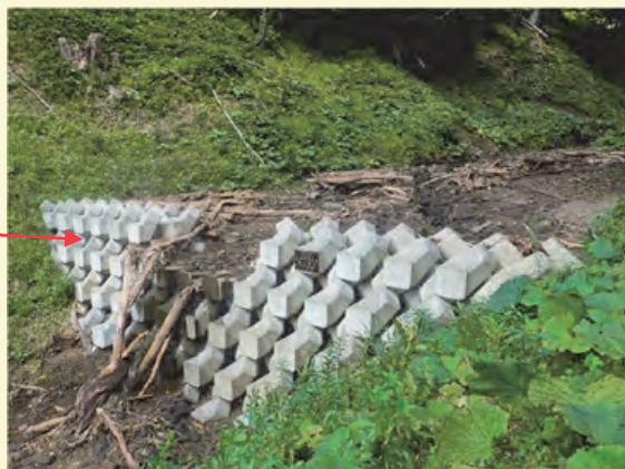
令和2(2020)年度に完成した 治山ダムによる土砂等の流出抑制効果 (北海道厚真町)
