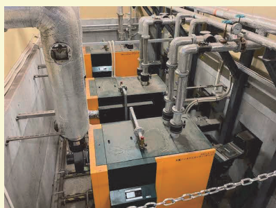
介護施設に導入されたボイラー
