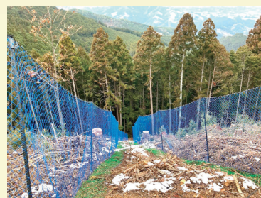
シカの歩き道を設けた 獣害防護柵設置箇所
