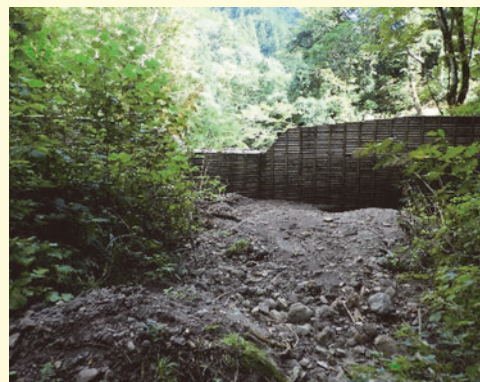
令和 6 年 7 月 25 日からの大雨後の状況 (No.1治山ダム上流側)
