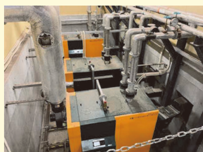
介護施設に導入されたボイラー
