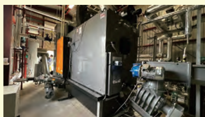
木質チップボイラー設備
