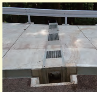
越前西部四号線に設置された横断溝
