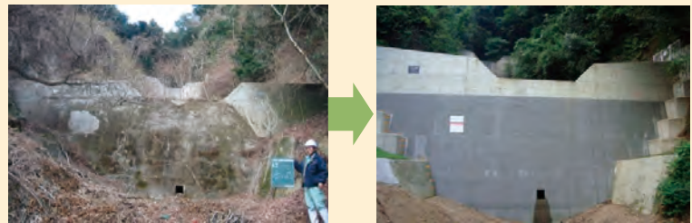
既存ダムをかさ上げ・増厚することにより機能強化・長寿命化(兵庫県神戸市)
