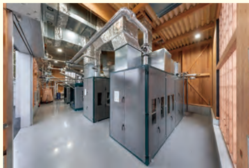
ガス化熱電併給設備
