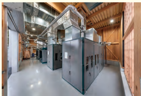
ガス化熱電併給設備
