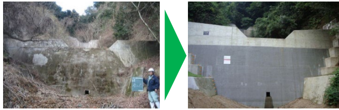
既存ダムをかさ上げ・増厚することにより 機能強化・長寿命化（兵庫県神戸市）
