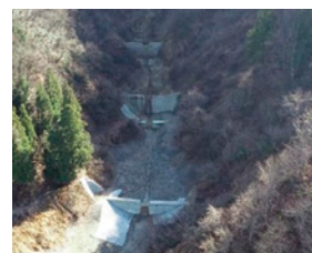
小規模な治山ダムを 階段状に配置
