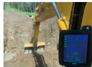
マシンガイダンス機能により正確な掘削ができるため、手戻りリスクを軽減
