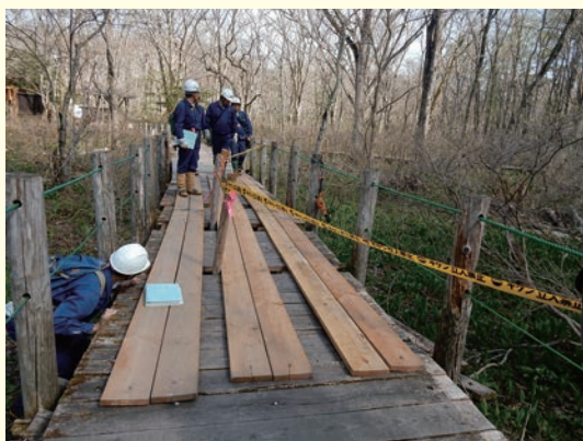
戸隠森林植物園の木道の損傷点検
