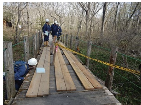
戸隠森林植物園の木道の損傷点検
