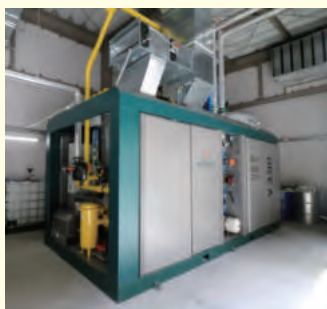
ガス化ユニット
