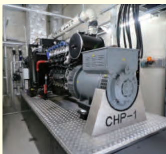
熱電併給ユニット
