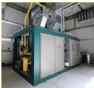
ガス化ユニット
