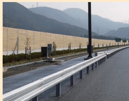
新東名高速道路 木製遮音壁
