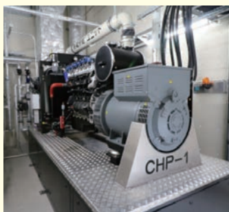
熱電併給ユニット
