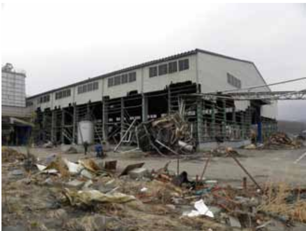
合板工場の被災状況 (岩手県宮古市)
