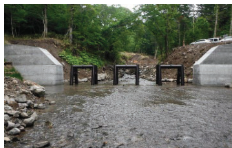
〔流木補足式治山ダム工 (北海道森林管理局後志森林管理署)〕
