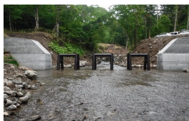
流木補足式治山ダム工 (北海道森林管理局後志森林管理署)
